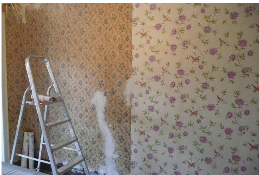
Uuden ja vanhan tapetin välinen ero näkyy
